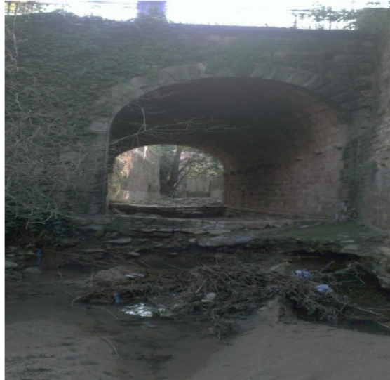
Φωτ. 4.4: Απότομη πτώση κατάντη του τεχνικού της οδού Στροφυλίου.
