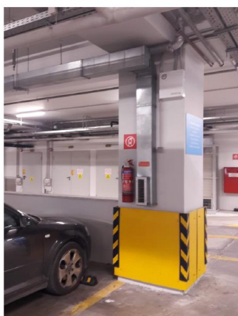
Εικόνα 3.1: Σύστημα εξαερισμού των καυσαερίων στον υπόγειο χώρο στάθμευσης.
