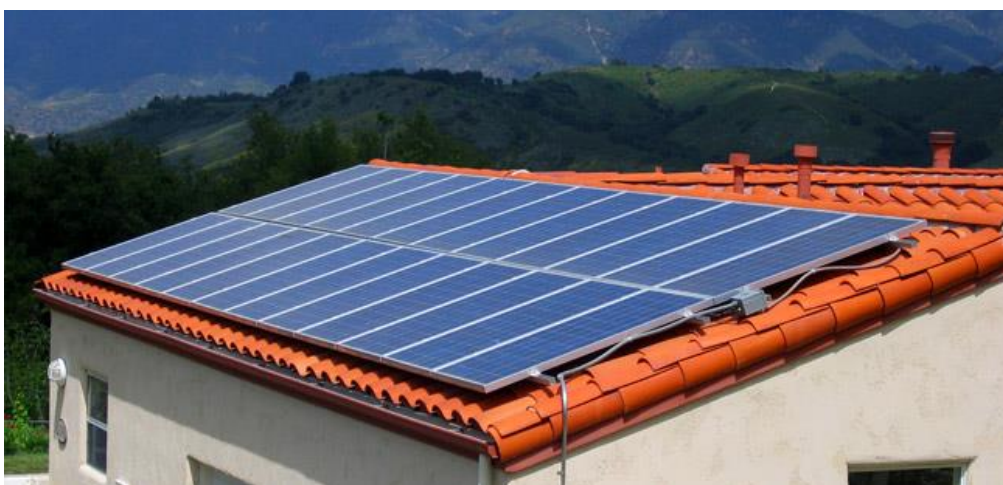
Εικόνα 8. Φ/Β εγκατάσταση σε στέγη
