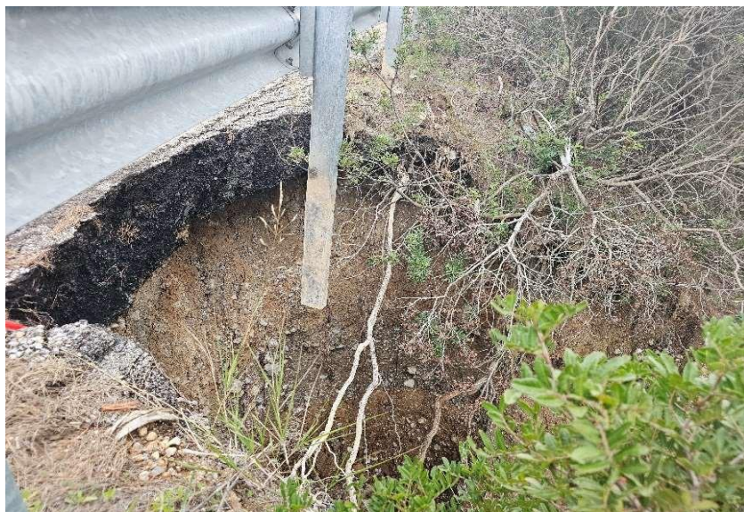
Εικόνα 1: Διευρυμένη και έντονη αστοχία οδοστρώματος εντός του καταστρώματος κυκλοφορίας στην πρώτη θέση που εξετάστηκε και προτείνονται μέτρα προς εφαρμογή
