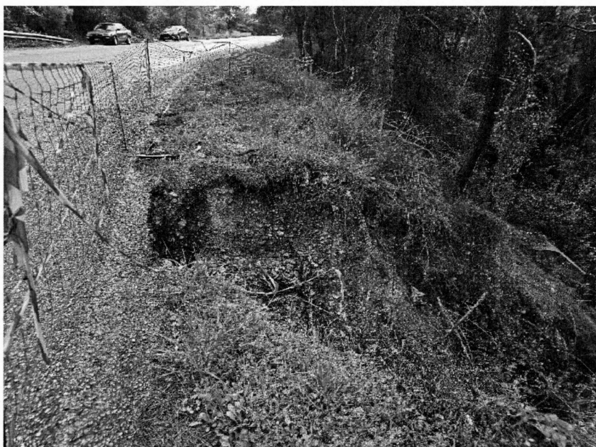
Εικόνα 2: Ηπιότερη αλλά κρίσιμη αστοχία οδοστρώματος εντός του καταστρώματος κυκλοφορίας στη δεύτερη θέση που εξετάστηκε και προτείνονται μέτρα προς εφαρμογή
