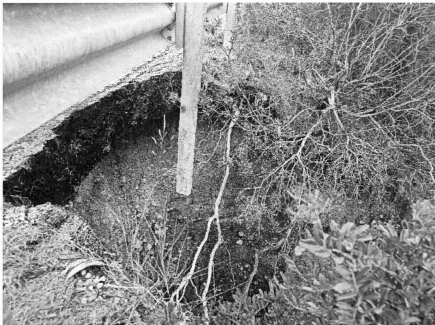
Εικόνα 1: Διευρυμένη και έντονη αστοχία οδοστρώματος εντός του καταστρώματος κυκλοφορίας στην πρώτη θέση που εξετάστηκε και προτείνονται μέτρα προς εφαρμογή
