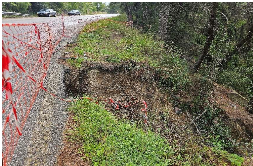
Εικόνα 2: Ηπιότερη αλλά κρίσιμη αστοχία οδοστρώματος εντός του καταστρώματος κυκλοφορίας στη δεύτερη θέση που εξετάστηκε και προτείνονται μέτρα προς εφαρμογή
