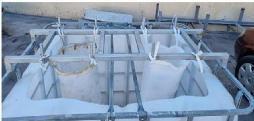
Εικόνα 2.2: Σύστημα φιλτρόσακκων εγκατάστασης.
