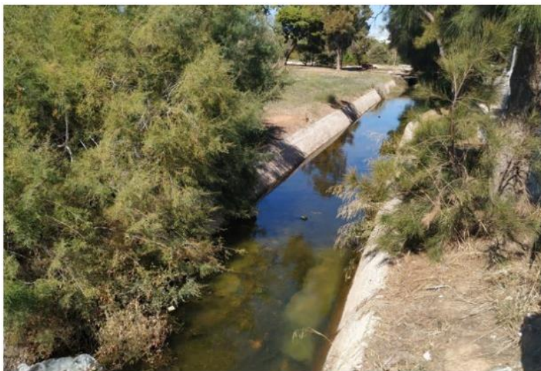
Εικόνα 3.5: Ανοιχτός αγωγός και έντονη δυσσομία (νοτιοανατολικό άκρο).
