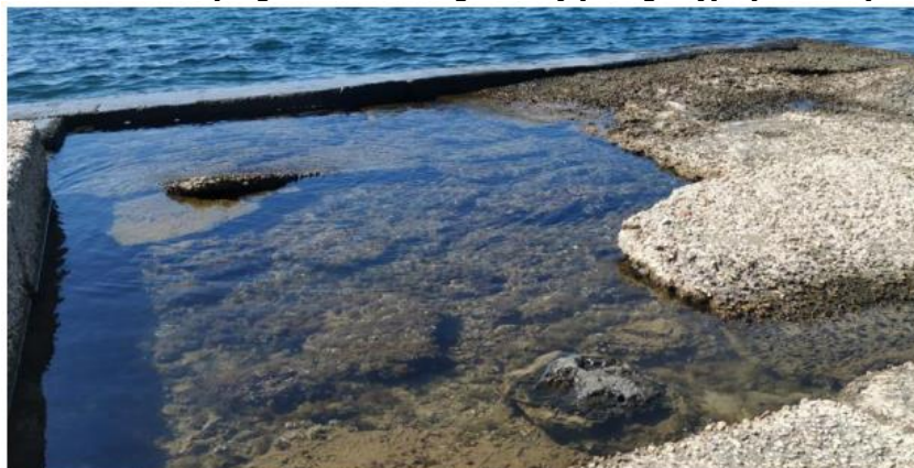
Εικόνα 3.2: Βλάβες και τοπικές καθιζήσεις τεχνητών νησίδων.
