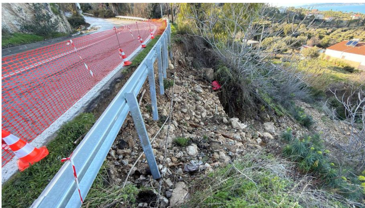
Εικόνα 3. Απεικόνιση βλαβών-υποχώρηση οδοστρώματος
